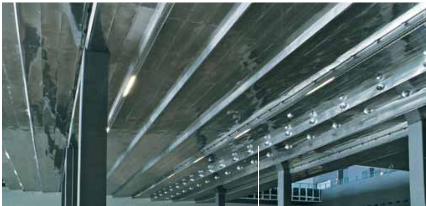
Condotture impianto climatizzazione integrate Integrated air-conditioning ducts
