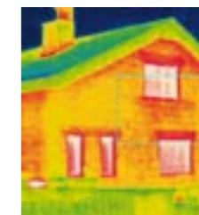
Vidna je izguba energije pri neustrezni fasadni izolaciji.
